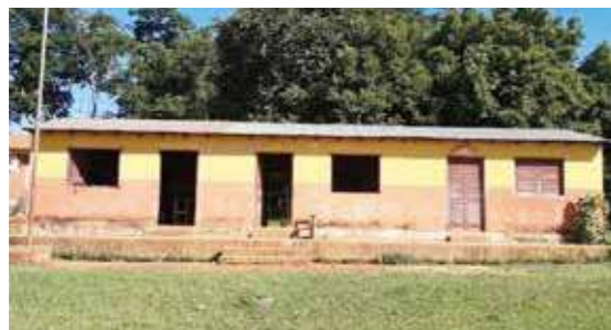
25/06/2019 Afirman que unas 13.000 aulas requieren reparación
